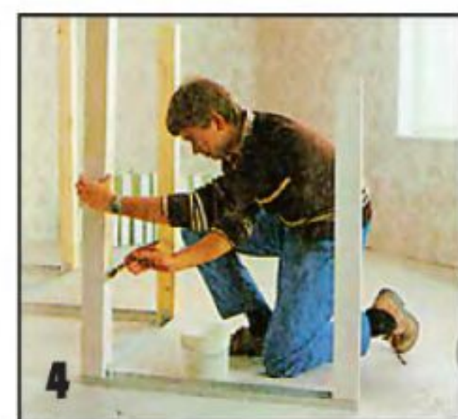
4 Кромки стоек, которые будут контактировать со стеклоблоками, покрывают краской. Остальные же поверхности стоек можно покрасить уже после укладки стеклоблоков.
